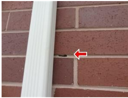
A. Picture 14 Mortar Gap
